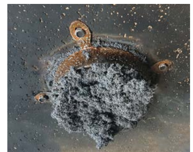
Feuer- und heißgasdichter Verschluss nach dem Auslösen der Brandschutzmanschette
